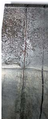
Figura 10: Región interior de la camisa, observándose la zona de alto deterioro superficial.
